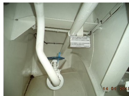
VÁLVULA DO SEPARADOR DE ÁGUA E ÓLEO NA PRAÇA DE MÁQUINAS.
