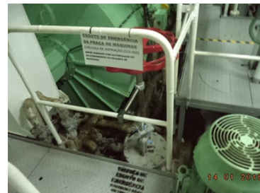
VÁLVULA DE ESGOTO DE EMERGÊNCIA NA PRAÇA DE MÁQUINAS
